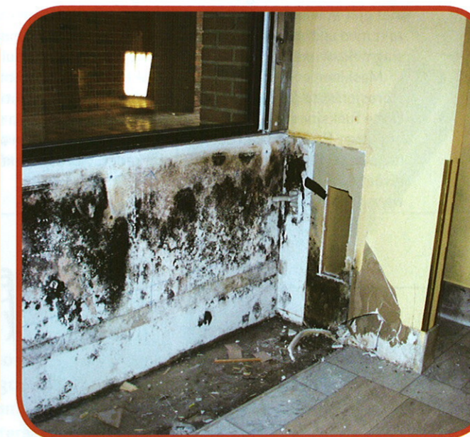
ANGREPET: Tilleggisolert kjellervegg med store muggsopp-skader (synlig etter avdekking).
