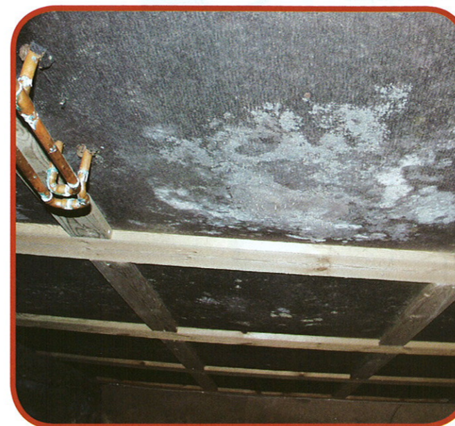
RISIKO: Tilleggisolert bjelkelag med moderne materialer gir ekstra skaderisiko.
