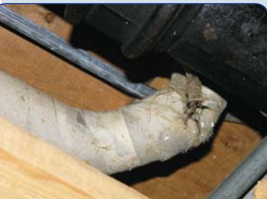
Asbest i isolasjon rundt rør.
